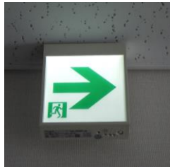
通路誘導灯（避難方向がわかる）
