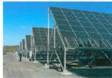
写真 9 大規模太陽光発電所
