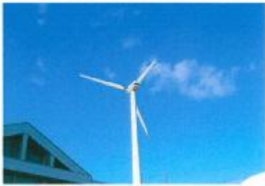
写真 2 稚内公園風力発電所
