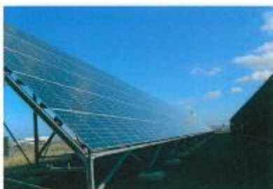
写真 10 大規模太陽光発電所
