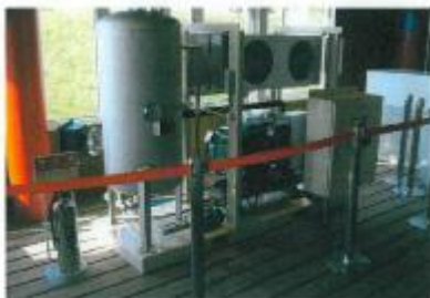
写真 4 大気吸熱型ヒートポンプ
