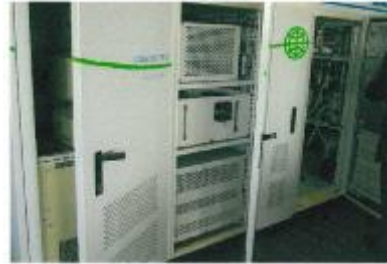
写真 3 水電解方式燃料電池
