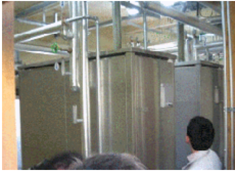
写真 6 ペレットボイラー
