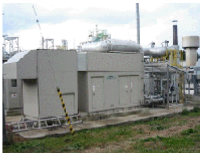
写真 5 バイオガス発電機
